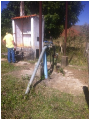
Vista externa poço 2
